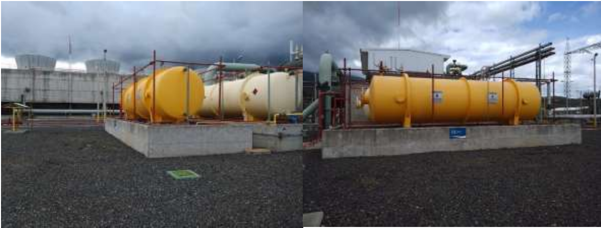
Tanque de reserva de pentano en buen estado.
