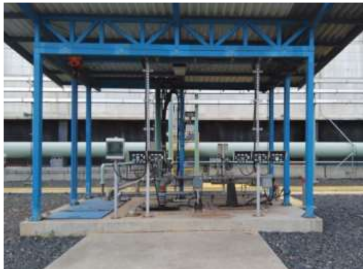
Sistema de recolección y neutralización de drenajes de condensados, se encuentran en buen estado.
