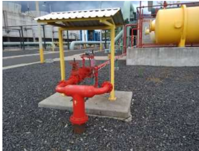
Vista de los tanques de pentano y sistema contra incendios
