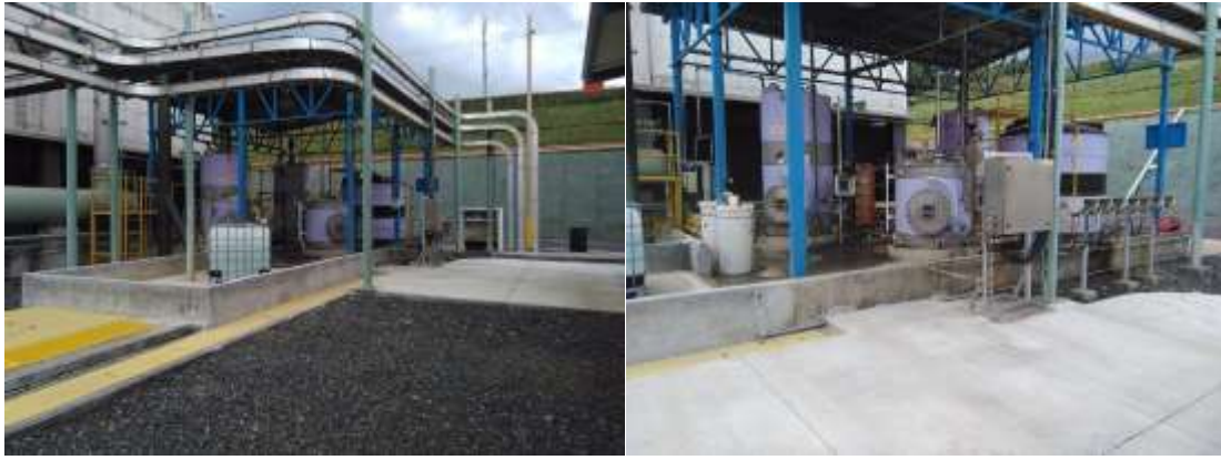
Sistema de soda, muros de contención de derrames se cuenta con un kit de contención de derrames de aceites en el laboratorio, esponjas y paños absorbentes.
