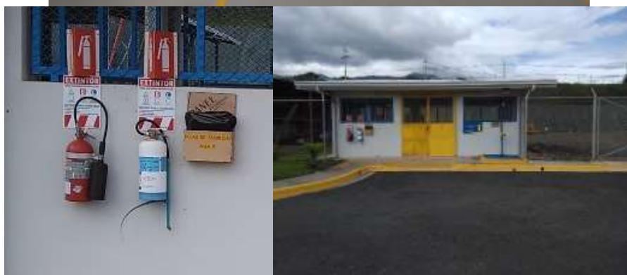
Vista de Bodega de químicos, extintores y hojas de seguridad
