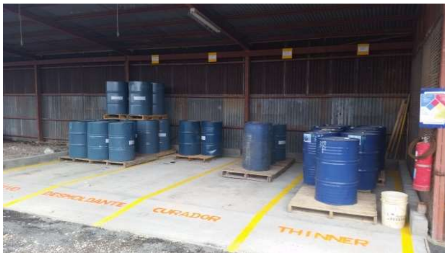
Figura 39. Área para almacenamiento de sustancias peligrosas en Almacenes.
