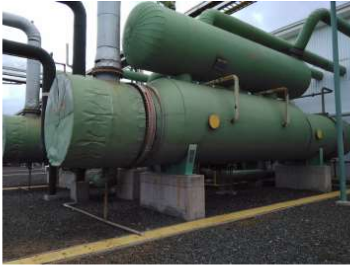
Evaporadores con cubiertas aislantes en buen estado.
