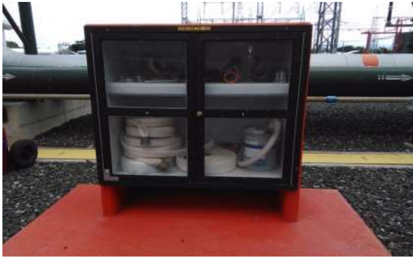
Gabinete con equipo contra incendios en buen estado, con mangueras, pitones y herramientas.
