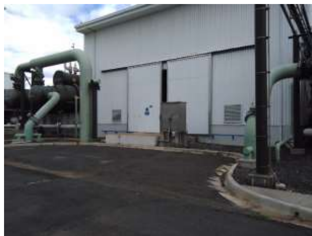
Aislamiento térmico y acústico de la caseta de turbina
