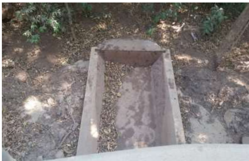
Figura 31. Sedimentador en el Proyecto Geotérmico Las Pailas II.
