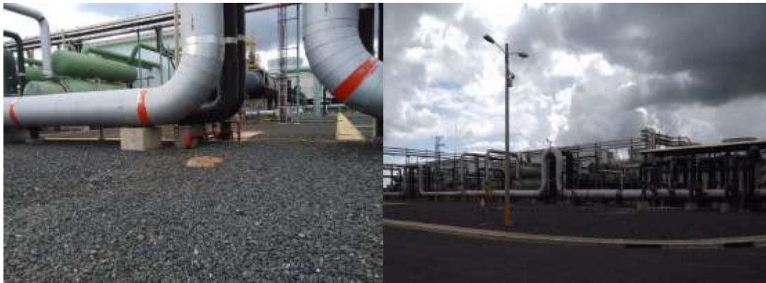
Tuberías recubiertas con forros aislantes térmicos en buen estado
