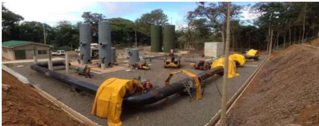
Figura 148. Estación de Separación 4
