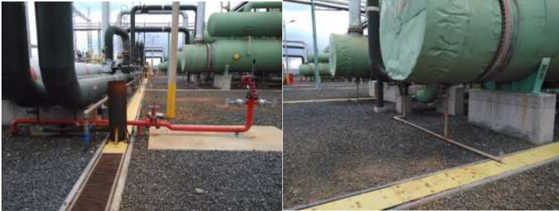
Drenajes de condensados en buen estado.
