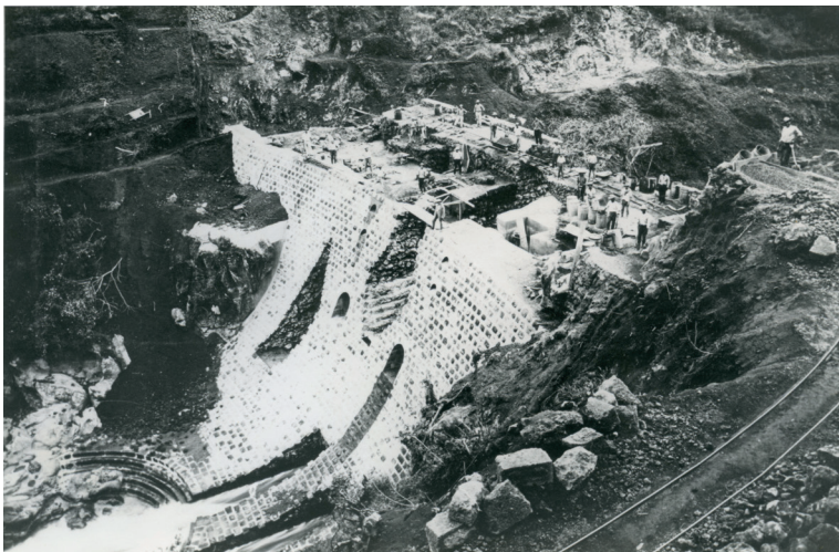
Planta hidroeléctrica Belén, construida en 1912.
