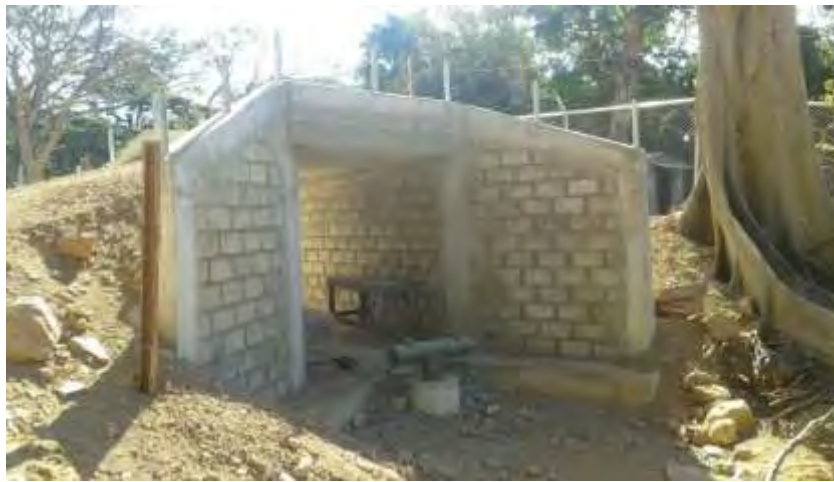
Figura 158. Paso-ducto ruta AS4-PL16 (1).
