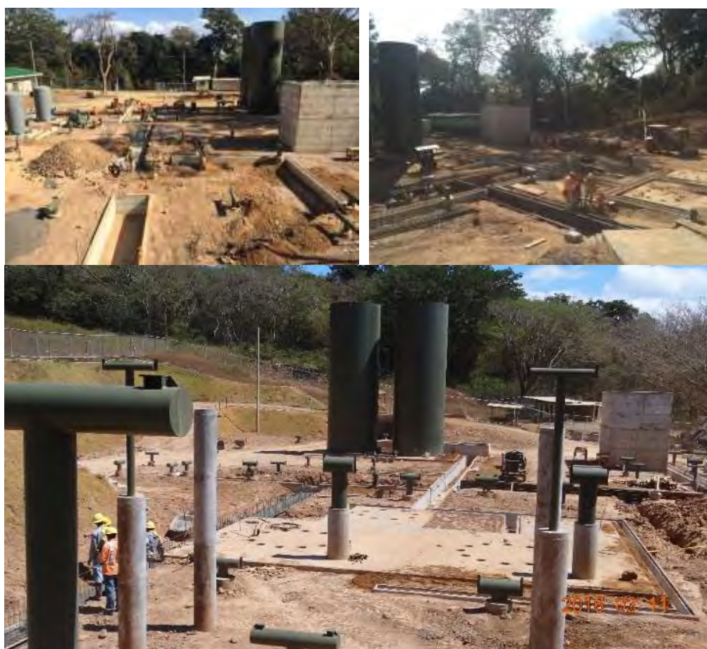
Figura 160. Estación Separadora 4, 3 y 2.
