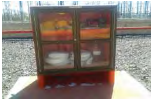
Gabinete con equipo contra incendios en buen estado, 15 de marzo
