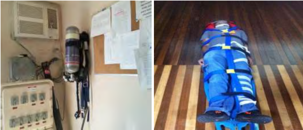
Figura 17. Equipos de escape rápido y atención de emergencias.
