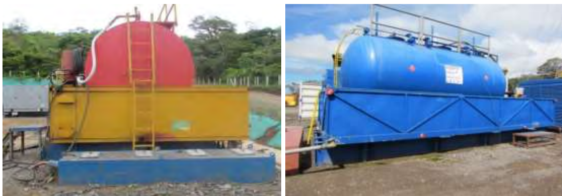
Figura 23: Tanques de combustible en perforadoras.
