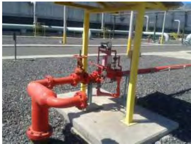
Vista de los tanques de pentano y sistema contra incendios, 15 de marzo
