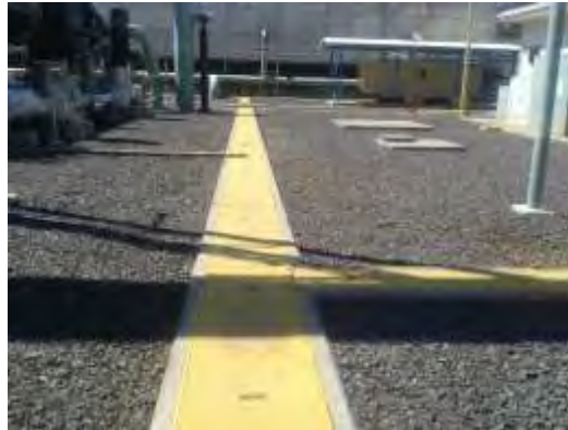
Sistema de recolección y neutralización drenajes de condensados, en buen estado 15 de marzo
