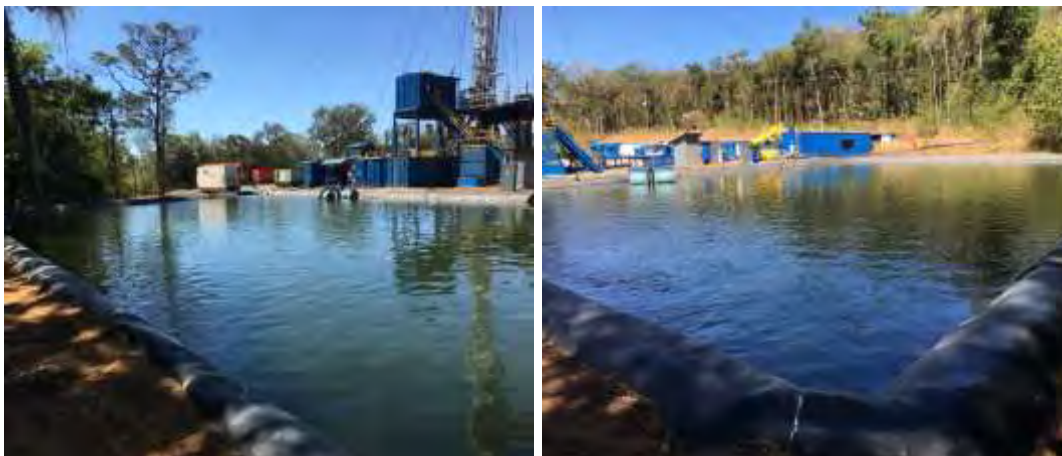
Figura 26. Lagunas utilizadas para el manejo de fluidos geotérmicos y de perforación.
