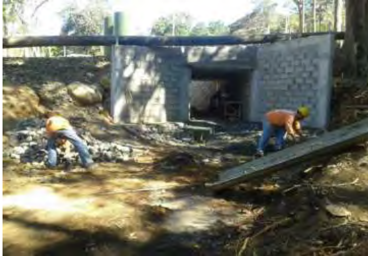
Figura 157. Paso-ducto ruta AS3-PL15.
