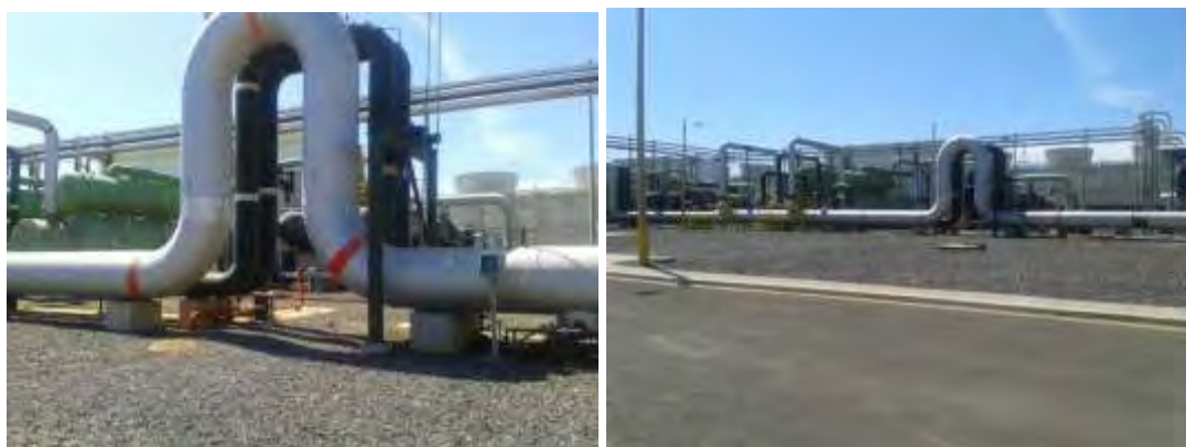
Tuberías recubiertas con forros aislantes térmicos, 15 de marzo.
