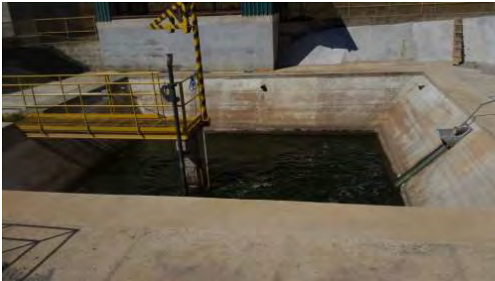
Tanque homogenizador y filtro de papeles.
