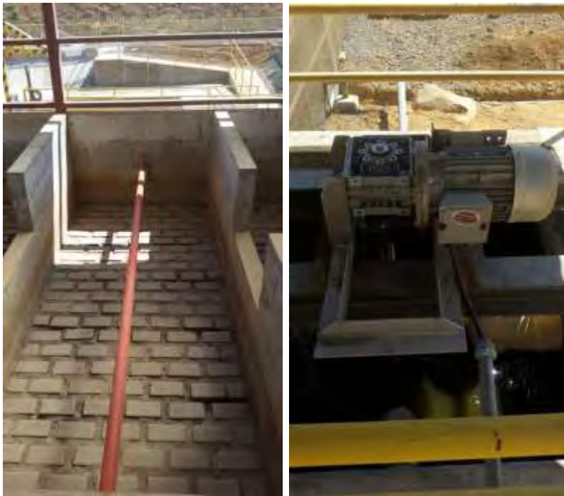
Lecho de secado limpio y agitador del bioselector.
