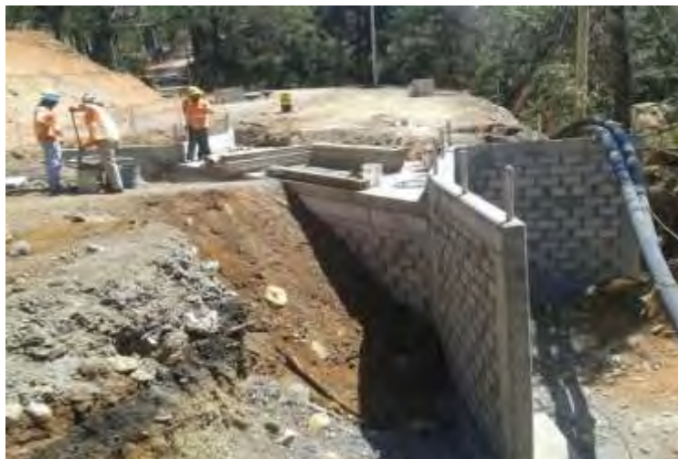
Figura 156. Paso-ducto Ruta AS4-PL16 (2).
