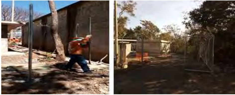
Figura 113. Tanque de almacenamiento ICE, I trimestre 2019.
