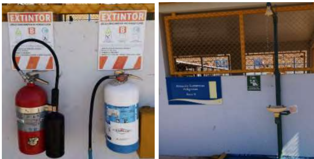
Figura 157. Extintores y ducha en funcionamiento ubicados en almacén de sustancias peligrosas, Área 9.
