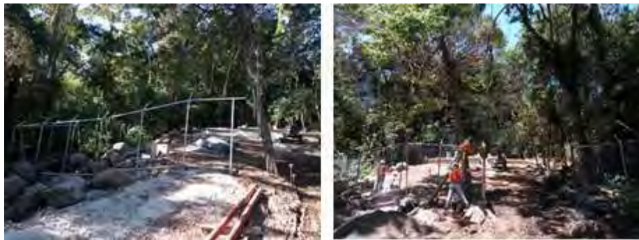
Figura 114. Toma de captación, I Trimestre, 2019.
