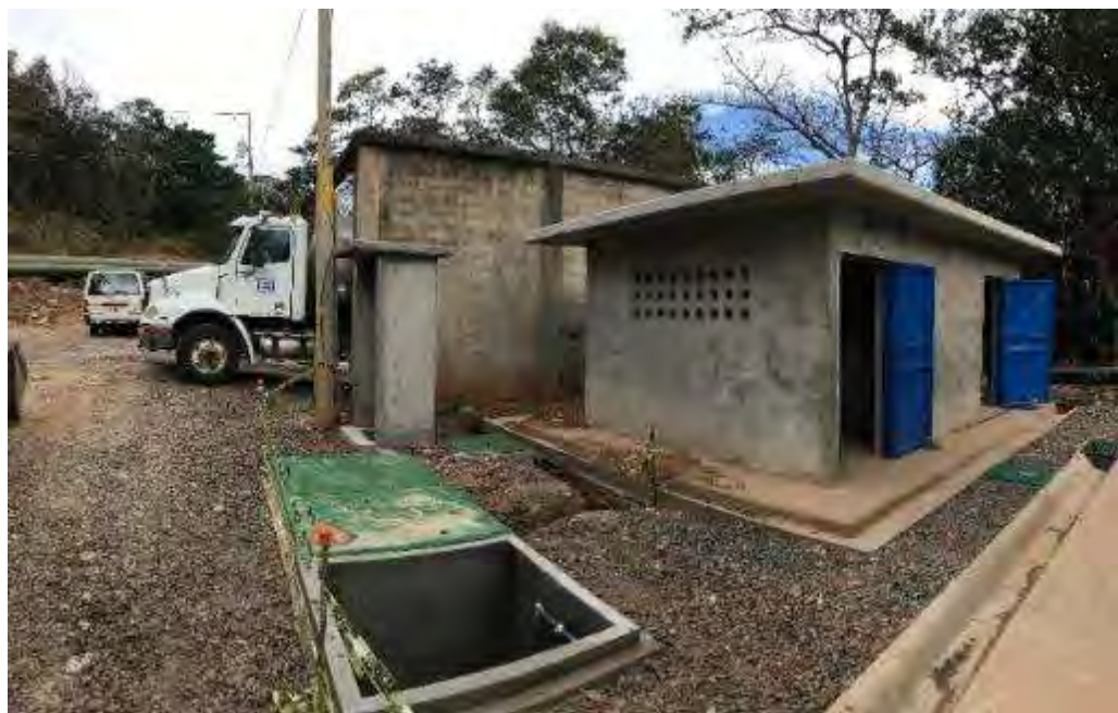
Figura 173. Caseta de cloración y tanque de almacenamiento.
