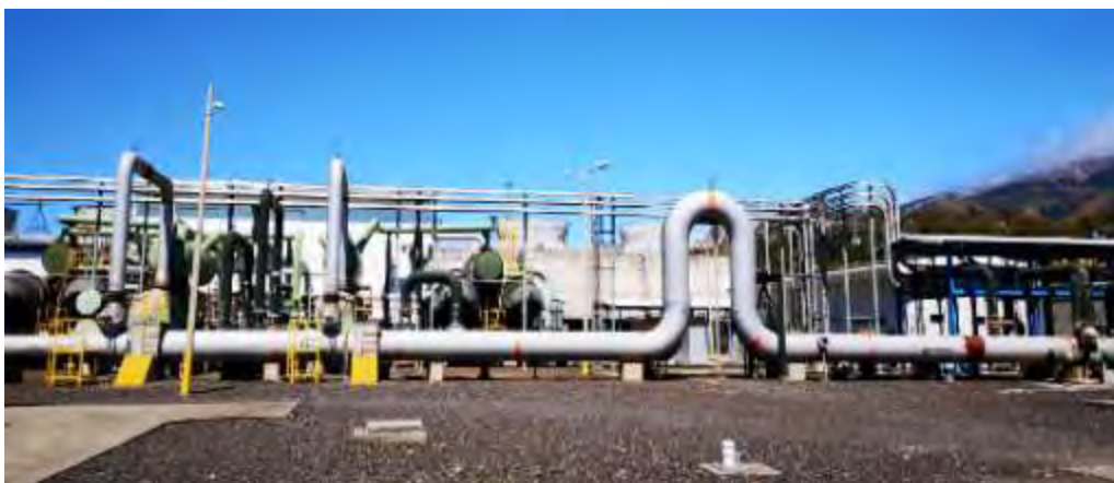
Figura 141. Uso de colores verdes y grises en tuberías que transportan vapor.
