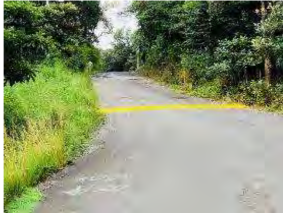
Figura 80. Reductor de velocidad. Proyecto Geotérmico Las Pailas Unidad II.
