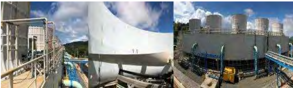
Figura 168. Instalación de extracción de gases de enfriamiento.
