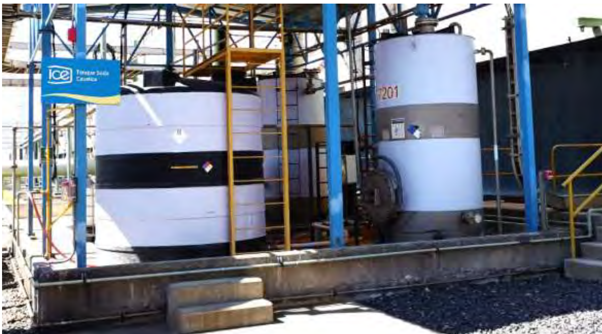
Figura 158. Tanque de soda cáustica con muros y drenajes para la contención de derrames.
