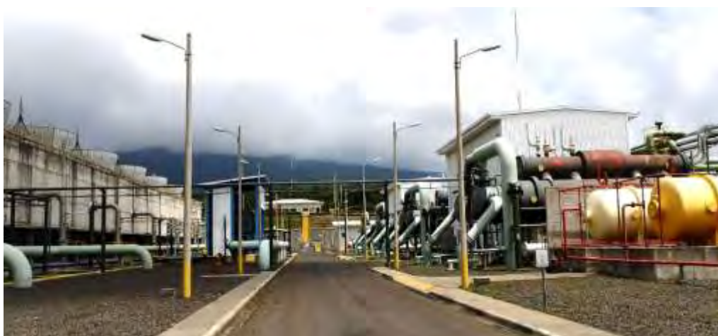
Figura 140. Vista de la Planta donde se observan tuberías y tanques de almacenamiento.
