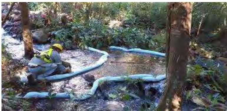
Figura 40. Colocación de barreras de contención de derrames sobre la Quebrada el Yugo.
