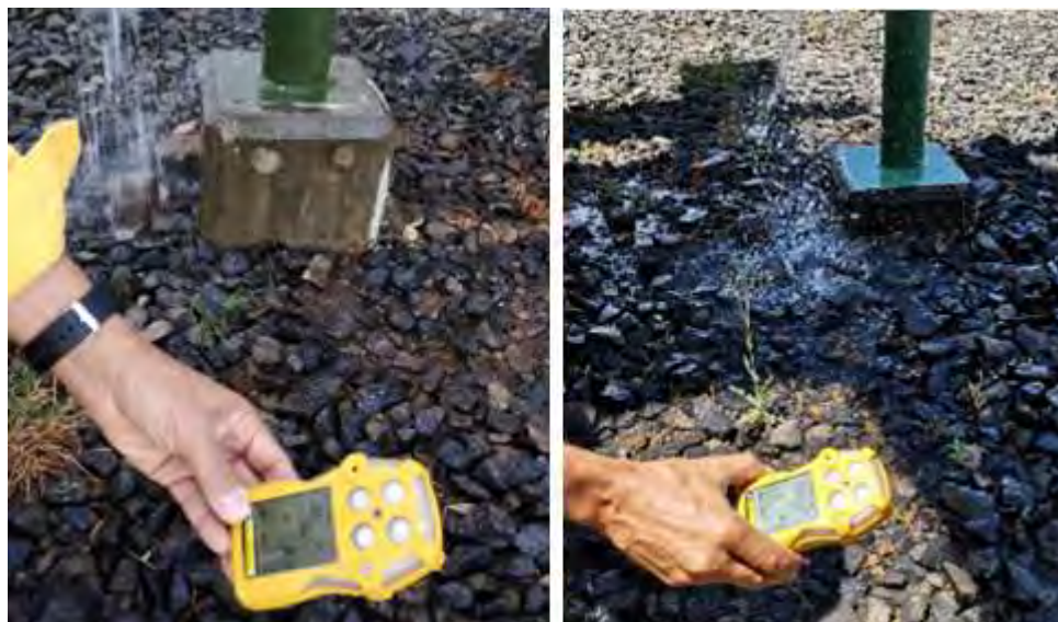
Figura 143. Medición de H 2 S (19/03/19) en OEC#1 y OEC#2. Valor de 0 ppm con drenaje cerrado y 6.3 ppm con drenaje abierto y Valor de 0 ppm con drenaje cerrado y 1.7 ppm con drenaje abierto, respectivamente.
