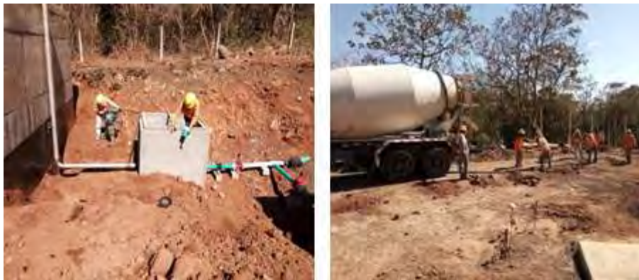
Figura 116. Tanque de almacenamiento Curubandé, I trimestre 2019.
