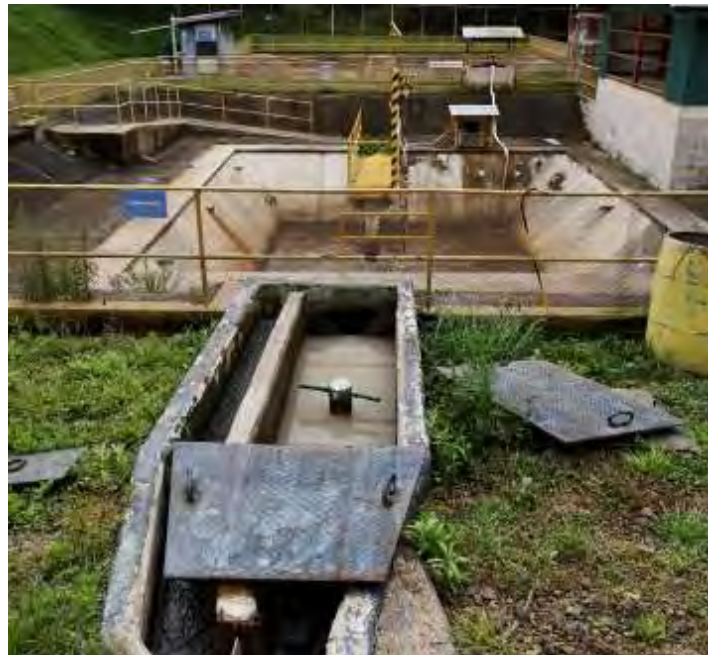
Figura 160. Planta de Tratamientos de Aguas Residuales en operación.
