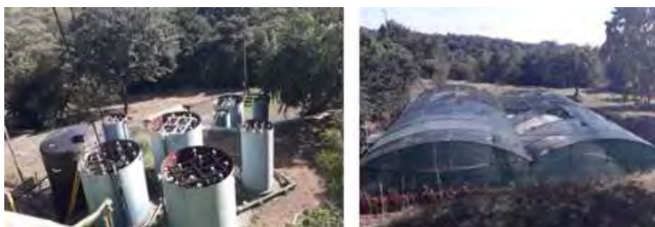
Figura 32. Planta de tratamiento de aguas residuales del Plantel de Curubandé.
