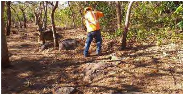
Figura 139. Mantenimiento de líneas corta fuegos de los alrededores de Casa de Máquinas II.
