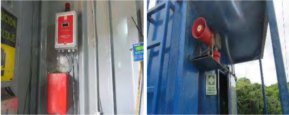
Figura 11: Detector fijos de gases y alarmas audibles.
