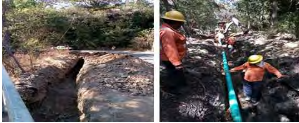
Figura 115. Tubería de Conducción, I trimestre 2019.
