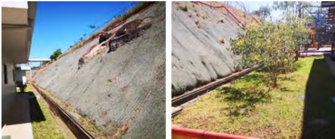
Figura 166. Talud en el sector noreste de la Planta y áreas verdes.
