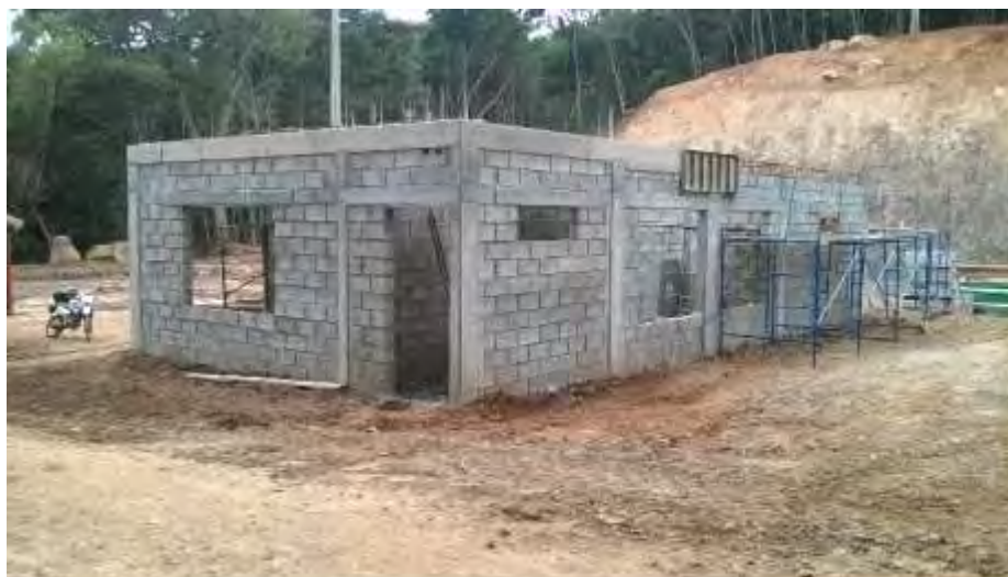
Figura 152. Caseta de Control Estación Separadora 4.
