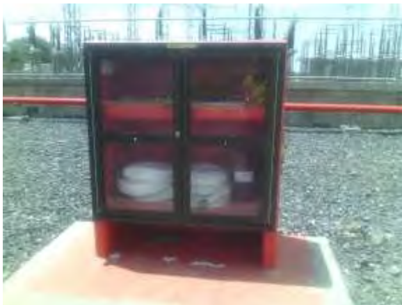
Gabinete con equipo contra incendios en buen estado, 28 de setiembre.
