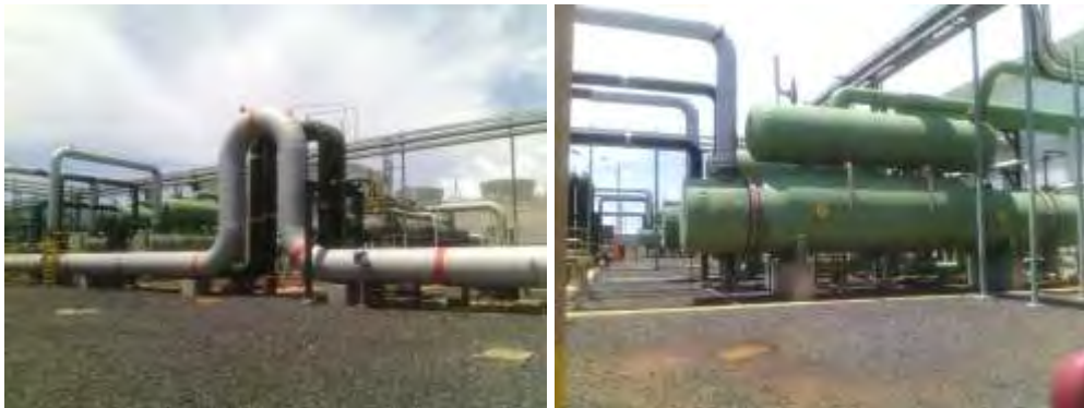
Tuberías recubiertas con forros aislantes térmicos, 28 de setiembre.
