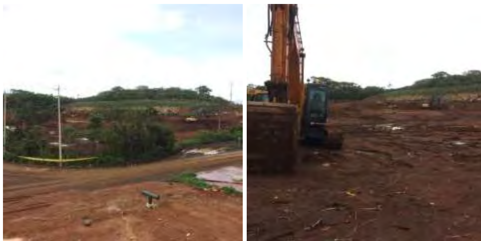
Figura 43. Trabajos de excavación de laguna 2, todavía no se implementan obras para manejo del agua de escorrentía superficial.
