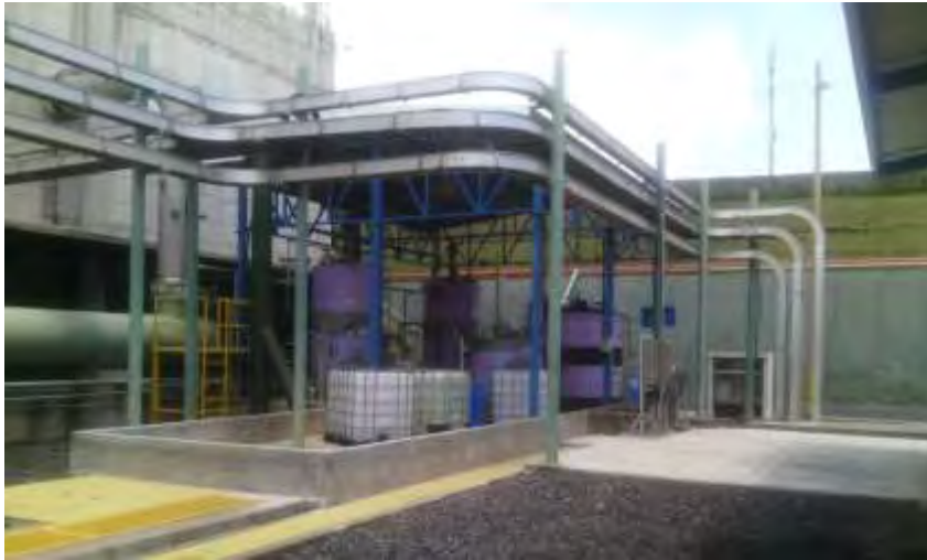
Sistema de soda, muros de contención de derrames se cuenta con un kit de contención de derrames de aceites en el laboratorio. 28 de setiembre.
