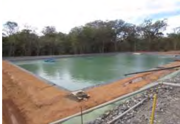
Figura 10. Lagunas utilizadas para el manejo de fluidos geotérmicos y de perforación
