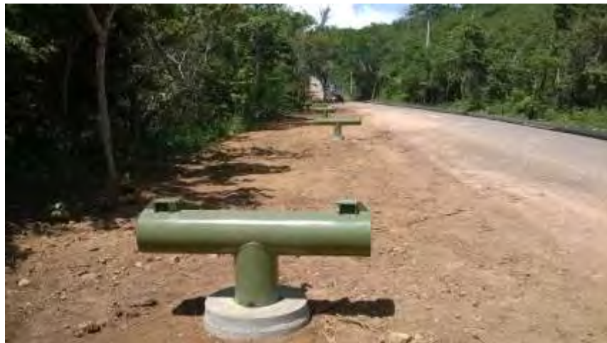
Figura 150. Cimientos Ruta V (VS3-Uva1) con soportes instalados.
