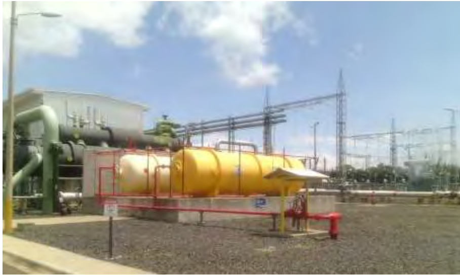
Vista de los tanques de pentano, 28 de setiembre.
