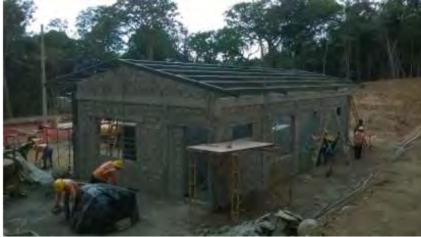
Figura 153. Caseta de Control Estación Separadora 3.
