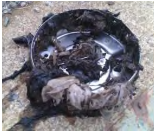
Suciedades en la las bombas de sumidero, setiembre.
