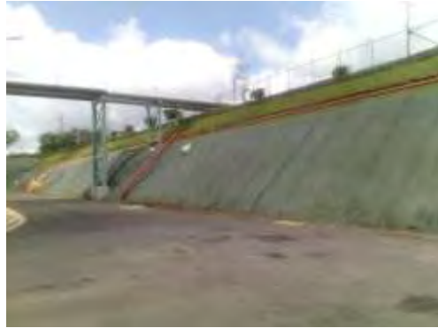
Vista de la malla de los taludes y caño al 28 de setiembre, hay que hacer algunas reparaciones.
