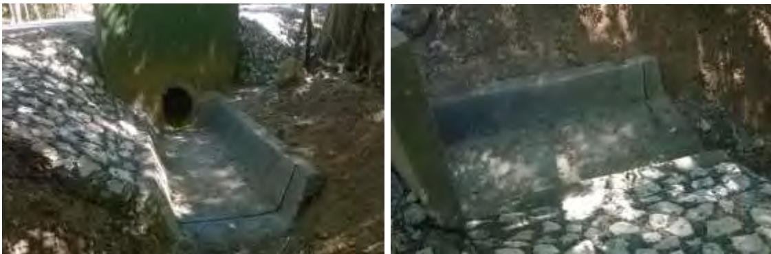
Figura 60. Inspección de sedimentadores para el monitoreo de turbidez.
