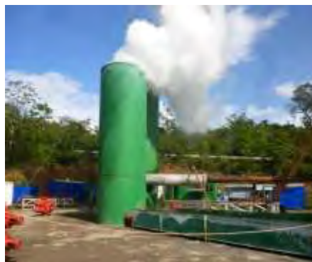
Figura 2. Prueba de producción en pozo geotérmico
