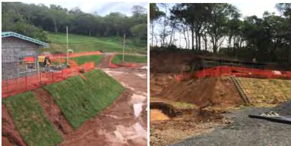
Figura 46. Satélites N° 2 y N° 3, respectivamente; se realiza la siembra de zacate en taludes pero todavía no se implementan las obras para manejo del agua de escorrentía.
