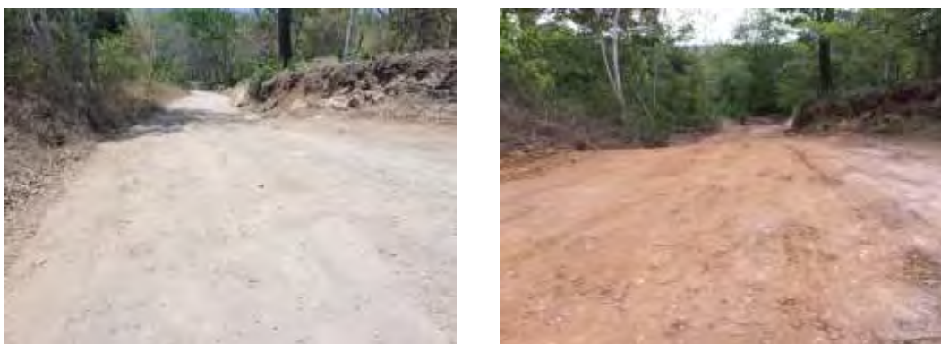
Figura 141. 01 de junio de 2015. Camino Agua Fría y 23 de julio de 2015. Trabajos camino Agua Fría.
