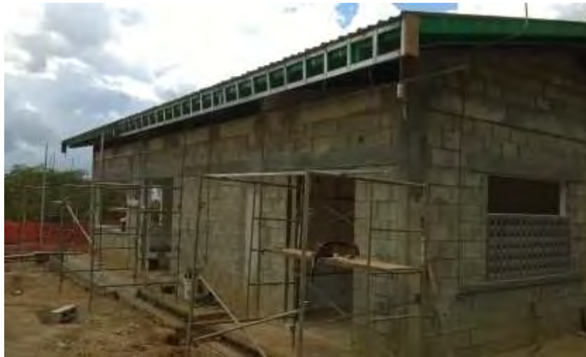
Figura 154. Caseta de Control Estación Separadora 5.
