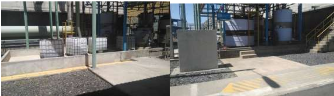
Figura 19. Sistema de soda con muros de contención de derrames
