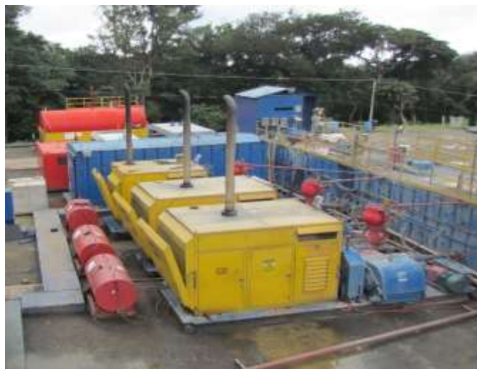
Figura 10. Sistemas de escape de equipos de perforación Cardwell KB-700.
