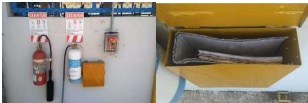
Figura 7. Extintores ubicados en el sector de la bodega de químicos.
