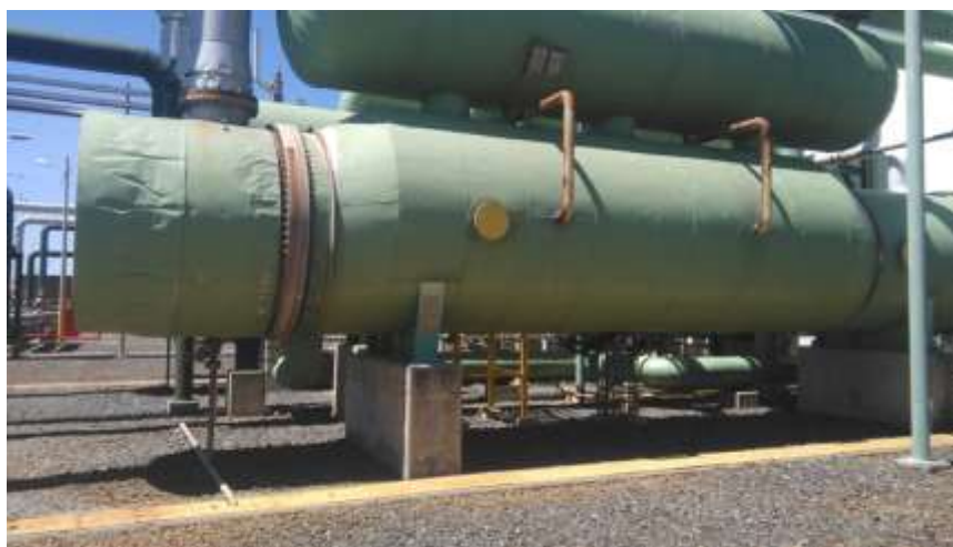
Figura 11. Recubrimientos térmicos de vaporizadores en buen estado.
