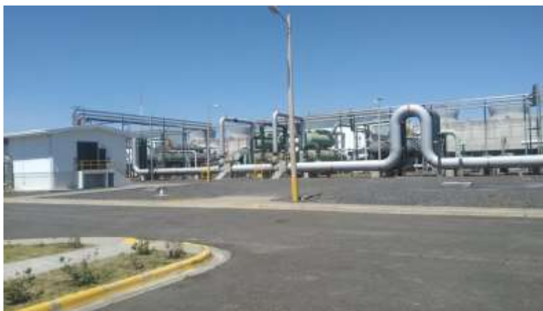
Figura 35. Estado de cubiertas aislantes.
