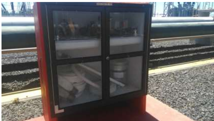
Figura 14. Gabinete con equipo contra incendios en buen estado, con mangueras, pitones y herramientas.
