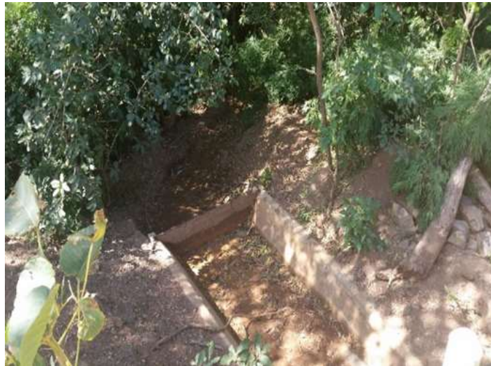
Figura 23. Sedimentador en el Proyecto Geotérmico Las Pailas II.
