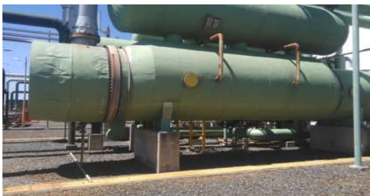
Figura 34 Vaporizadores de pentano con aislamiento térmico en buen estado
