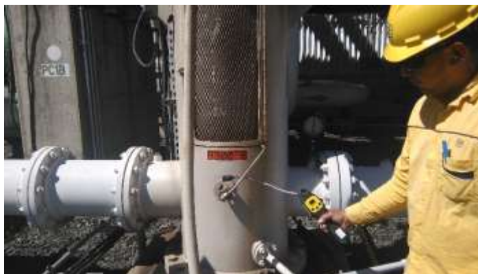
Figura 30. Detectores de fugas de pentano y H_2S .
