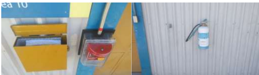
Figura 2. Hojas de seguridad y extintor en bodega de inflamables.
