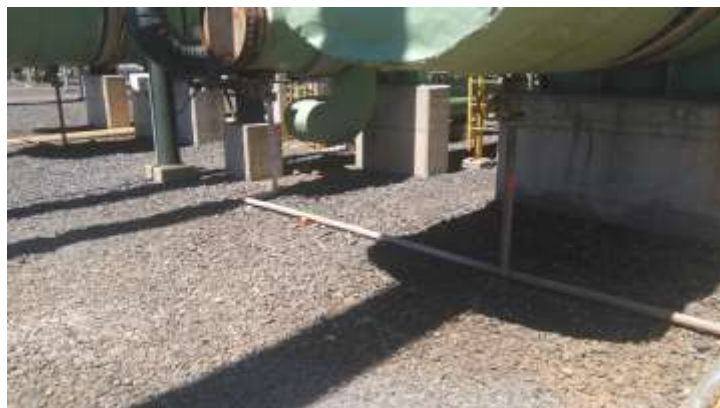
Figura 32 Vista del sistema de drenajes de condensados
