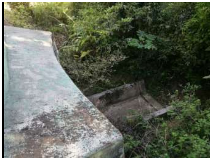
Figura 57. Inspección de sedimentadores en febrero 2018. La estructura carece de la barrera para la detención del sedimento.
