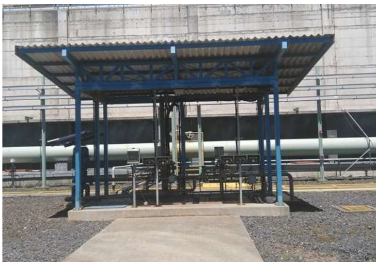
Figura 33. Tanque de drenajes de condensado.
