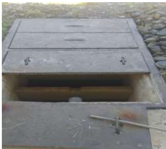
Figura 5. Vista del tanque de contención de derrames.
