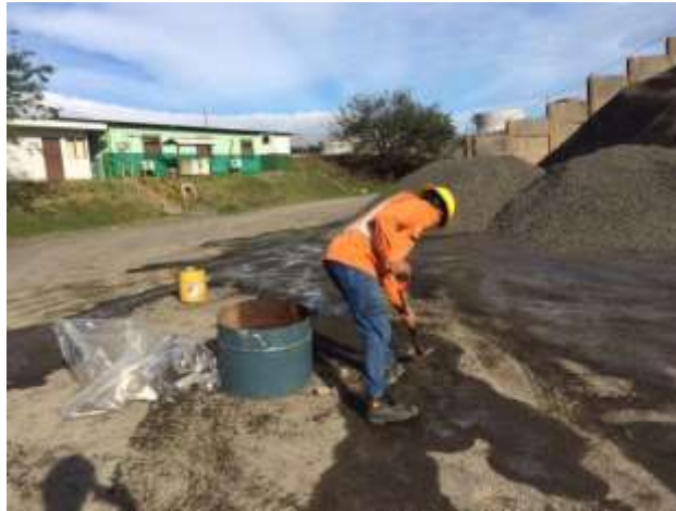
Figura 38. Atención de un derrame de hidrocarburos.
