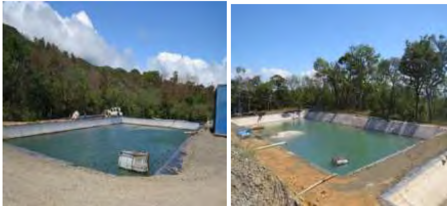
Figura 20. Lagunas almacenamiento de fluidos geotérmicos y de perforación en PLP-13 y PLP-12.
