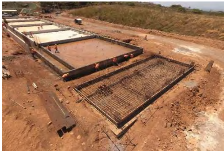
Figura 144. Avance en la pileta de la Torre de Enfriamiento y el edificio de Dosificación química.
