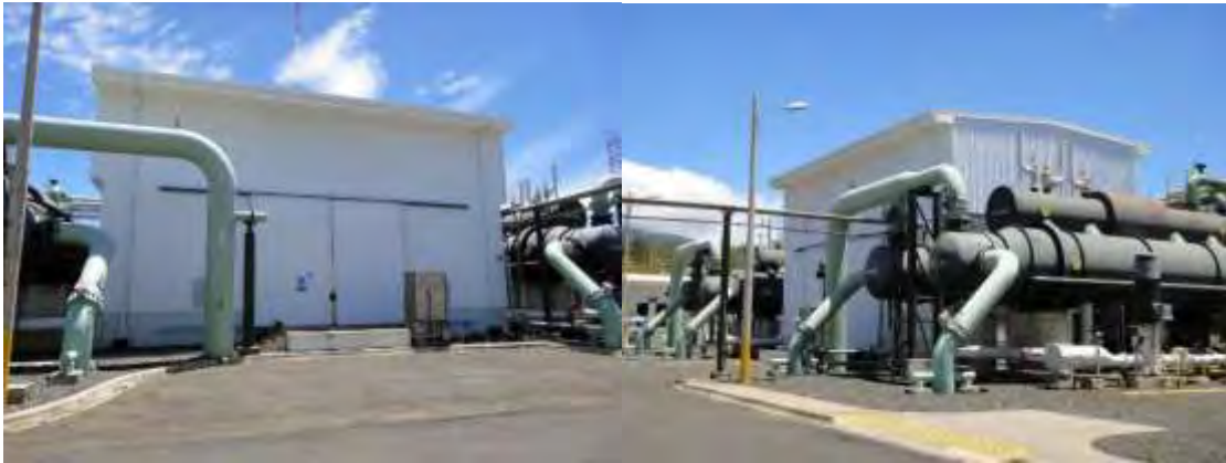
Figura 21. Aislamiento térmico y acústico de la caseta de turbina.
