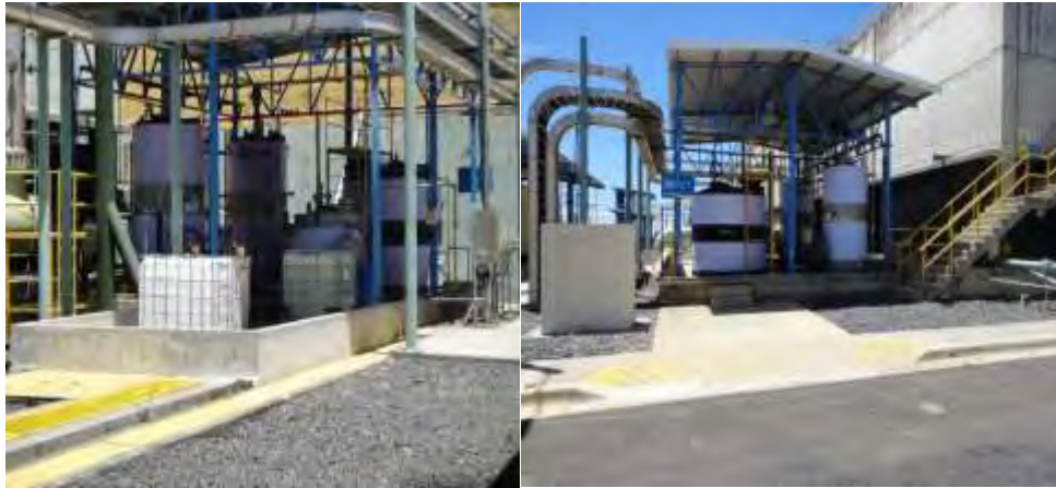
Figura 10. Sistema de soda con muros de contención de derrames
