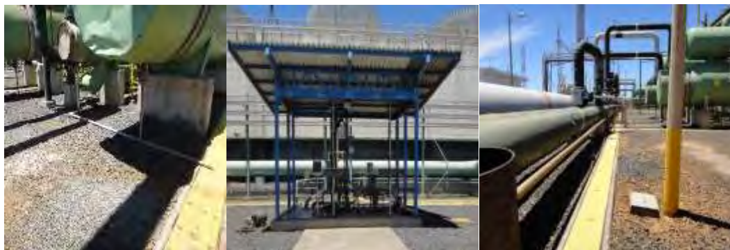
Figura 19. Drenajes de condensados en buen estado el día 13 de marzo del 2017.
