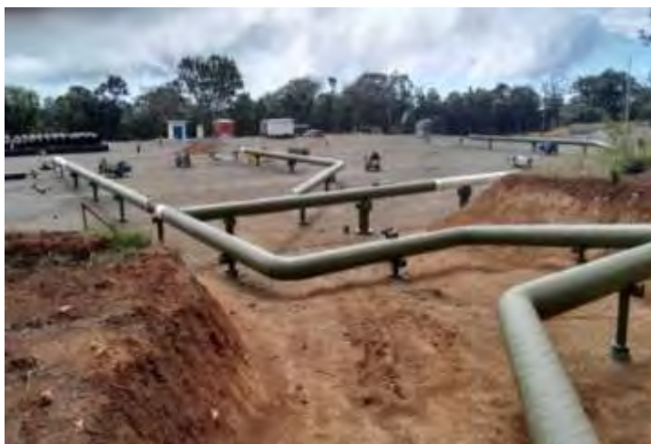
Figura 148. Tubería de la PL-15.
