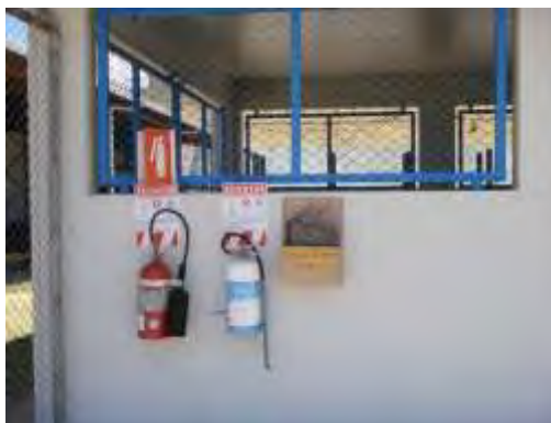
Figura 5. Extintor, y hojas msds, ubicados en el sector de la bodega de químicos.
