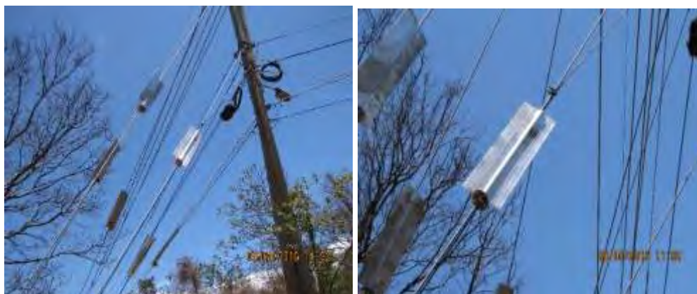
Figura 112. Láminas antiescalamiento colocadas en LD.
