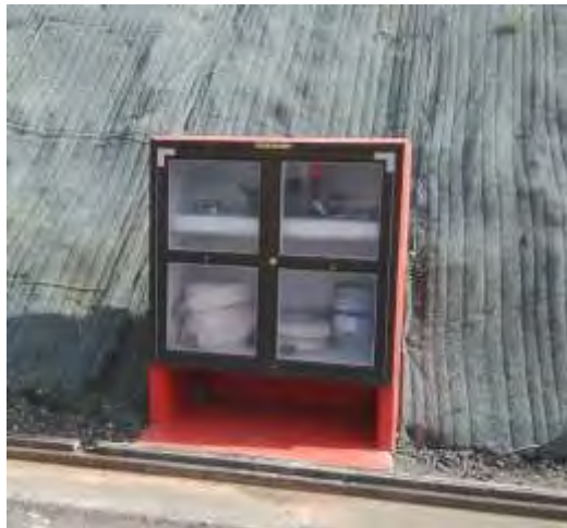
Figura 7. Gabinete con equipo contra incendios en buen estado, con mangueras, pitones y herramientas.
