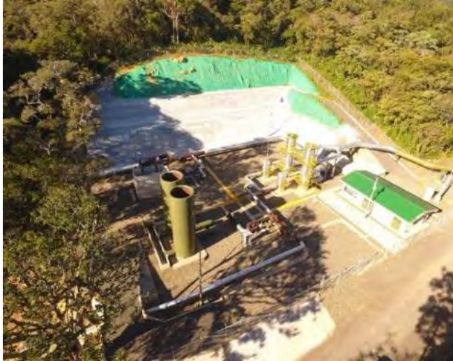
Figura 154. Estación Separadora N°4.
