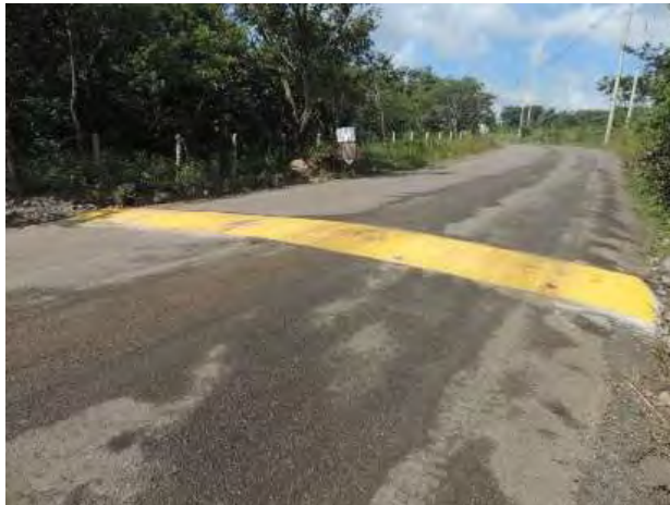
Figura 83. Reductor de velocidad ubicado en los accesos a sitios de obra.
