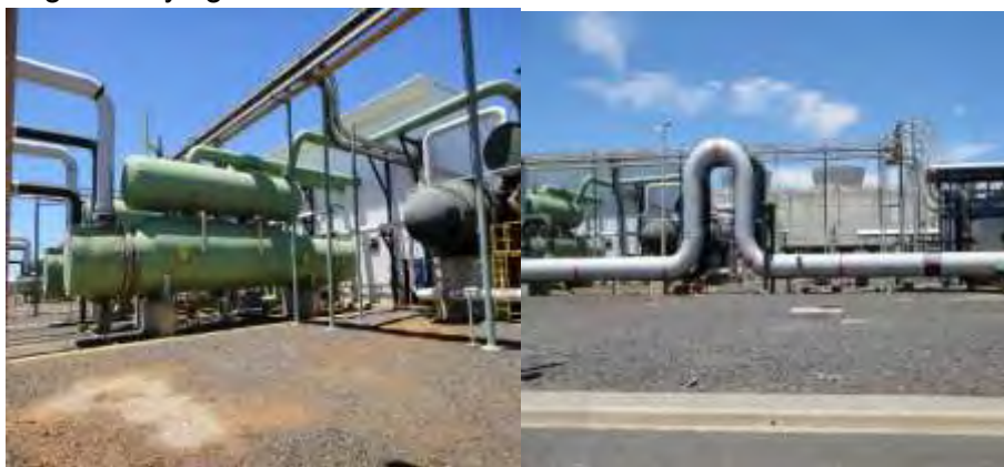
Figura 20 .Estado de cubiertas aislantes de precalentadores y vaporizadores.
