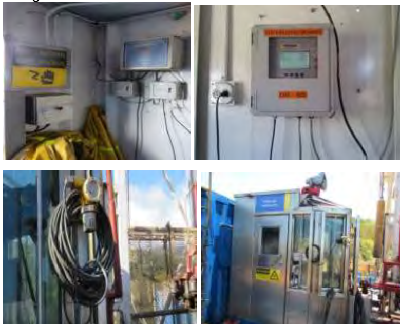
Figura 15. Detectores fijos con sistema de alarmas audibles de H 2 S y CO 2 .
