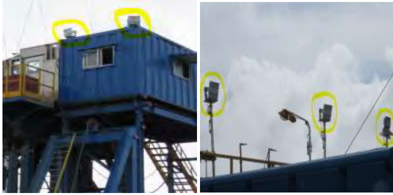
Figura 116: Luminarias LED en perforadora K-PEM.
