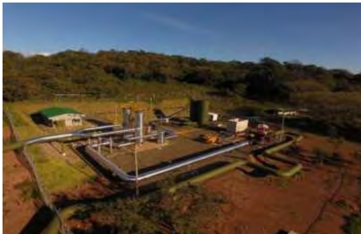
Figura 152. Estación Separadora N°2.
