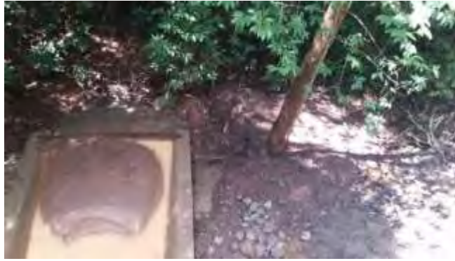
Figura 27. Sedimentador en el Proyecto Geotérmico Las Pailas II.
