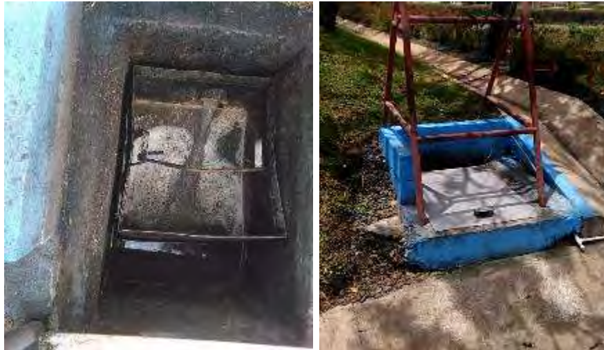
Figura 40. Vista del tamiz de gruesos del comedor, se limpia tres veces por día. Agosto 2018.
