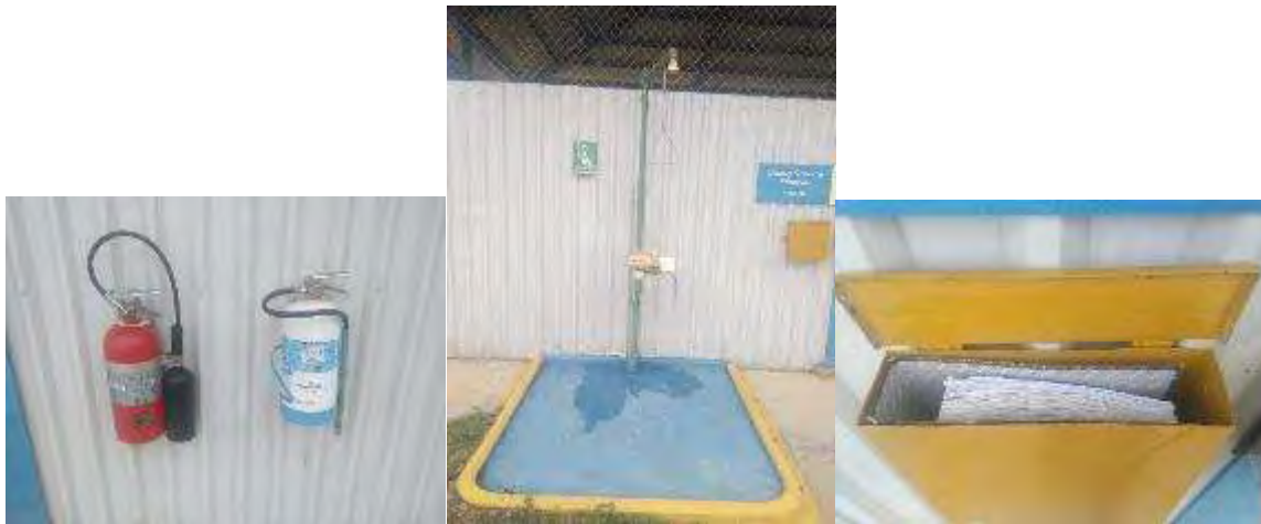
Figura 2. Todos los extintores ya están en su lugar y recargados, las hojas de seguridad están bien. Agosto, 2018.
