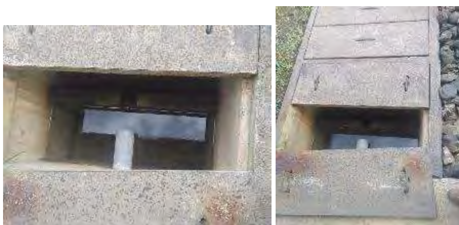
Figura 5. Vista del tanque de contención de derrames, hay que sacar algo de agua de lluvia. NO hay derrames, agosto.
