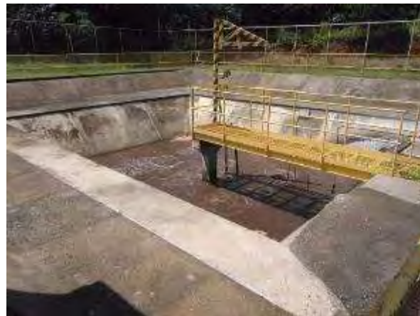
Figura 30. Vista del tanque reactor biológico, condiciones normales. Septiembre, 2018.
