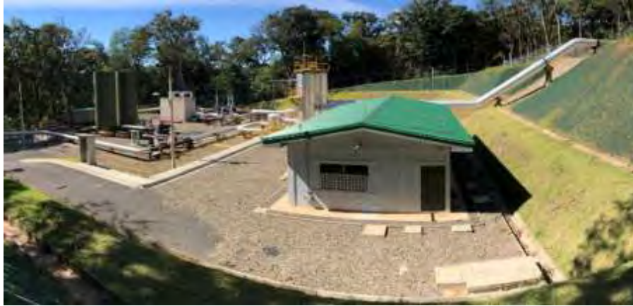
Figura 141. Avances en Estaciones Separadoras.
