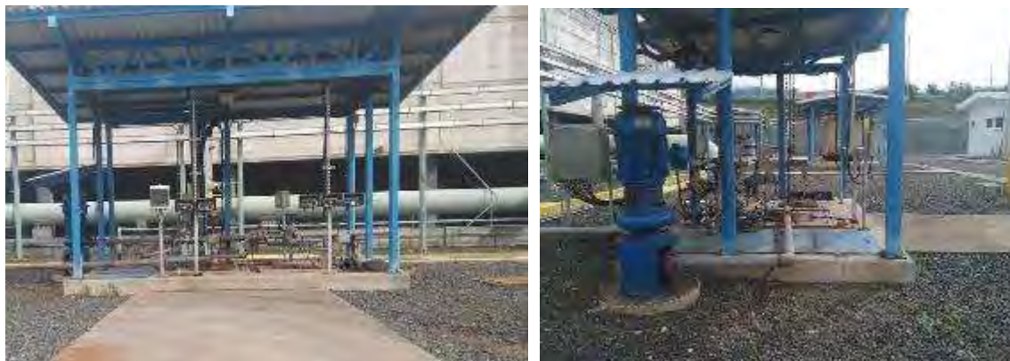
Figura 53. Tanque de drenajes de condensado en buen estado, setiembre 2018.
