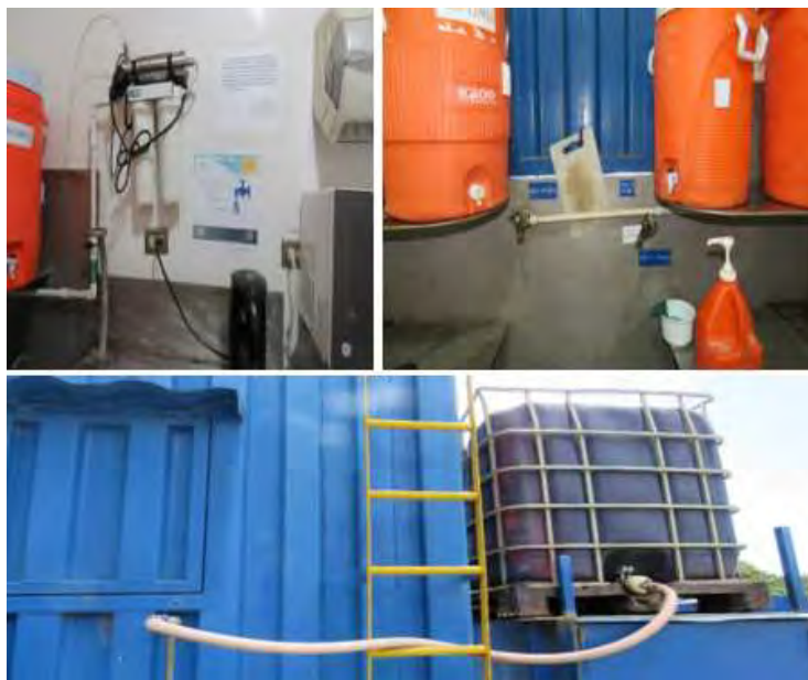
Figura 16. Sitios rotulados para agua potable y no potable.
