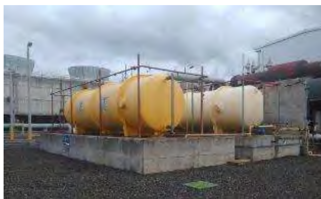
Figura 57. Tanques de pentano, pintura y sistema de aspersión en buen estado. Agosto 2018.
