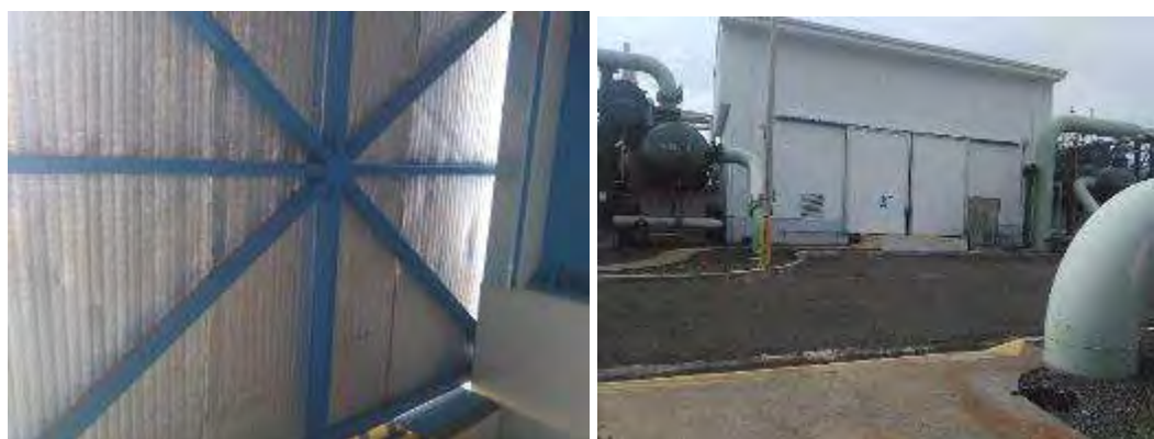
Figura 56. Aislamiento térmico y acústico de la caseta de turbina está en buen estado. Las puertas están cerradas. Agosto 2018.
