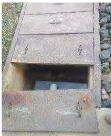
Figura 22. Trampa de aceites de la bodega de inflamables y almohadillas. Agosto, 2018.
