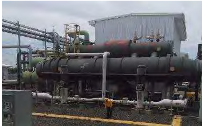
Figura 9. Medición de fugas de pentano. Agosto, 2018.
