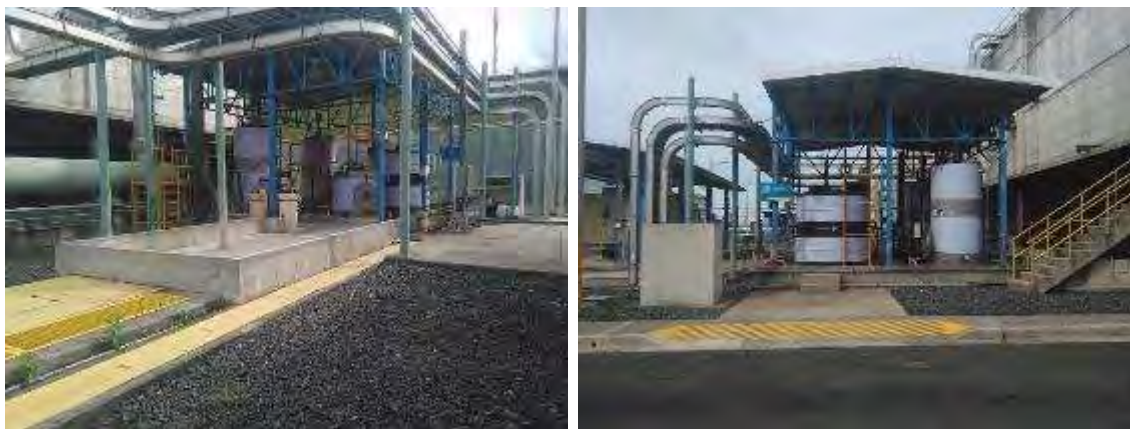
Figura 24. Sistema de soda con muros de contención de derrames, 22 de agosto 2018.
