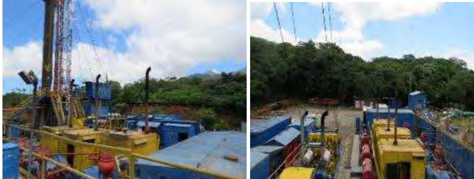
Figura 7. Sistemas de escape de equipos de perforación Cardwell KB-700.
