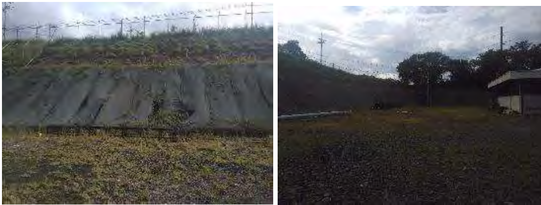
Figura 44. vista de los taludes por el almacén, hay daños en algunas partes, ya se realizaron algunas reparaciones, pero falta.
