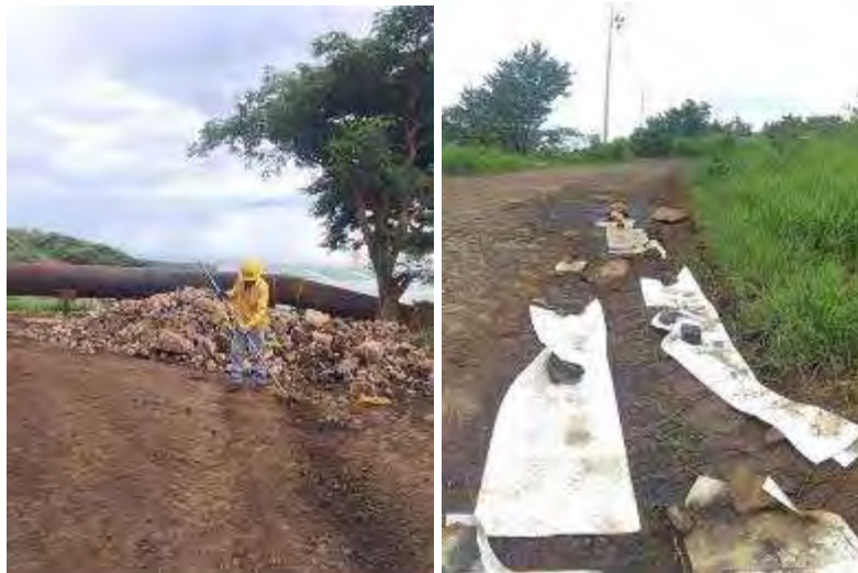
Figura 31. Atención de un derrame de hidrocarburos.
