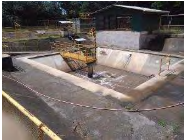
Figura 29. Vista de Tanque homogenizador. Septiembre, 2018.
