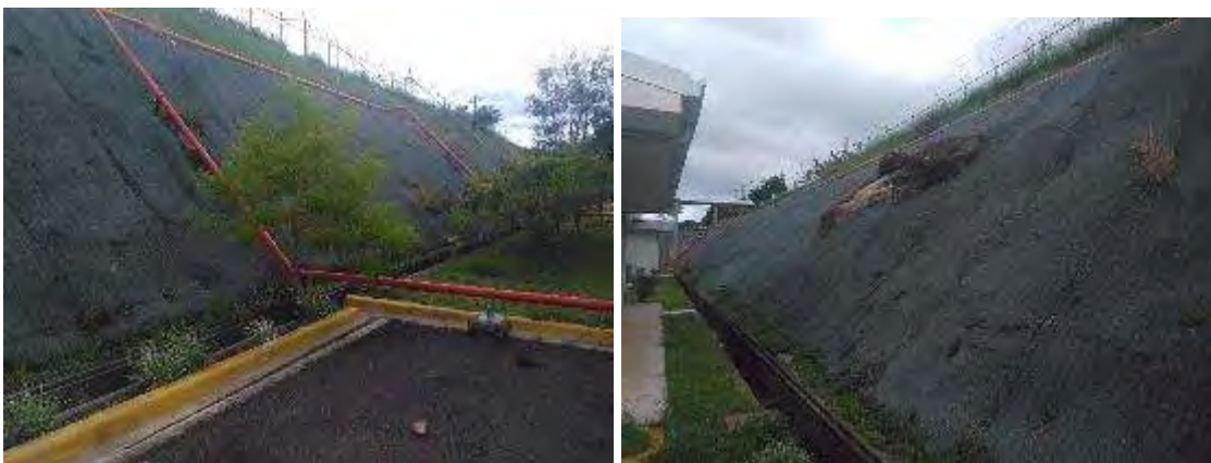
Figura 45. Taludes estabilizados con geo-membranas sintéticas en la Planta Geotérmica Pailas 1, ya hay que hacer algunas reparaciones. Agosto, 2018.
