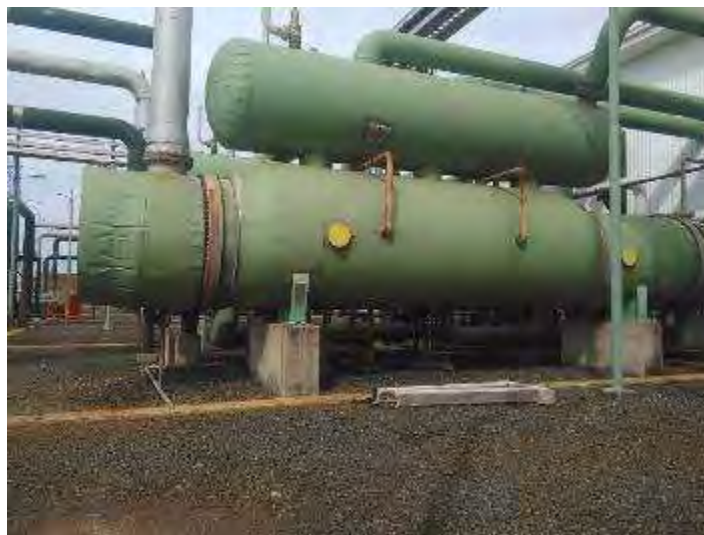
Figura 54. Vaporizadores de pentano con aislamiento térmico en buen estado. Agosto 2018.
