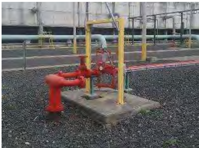
Figura 58. Tanques de pentano con sistema de rociado en buen estado, agosto 2018.
