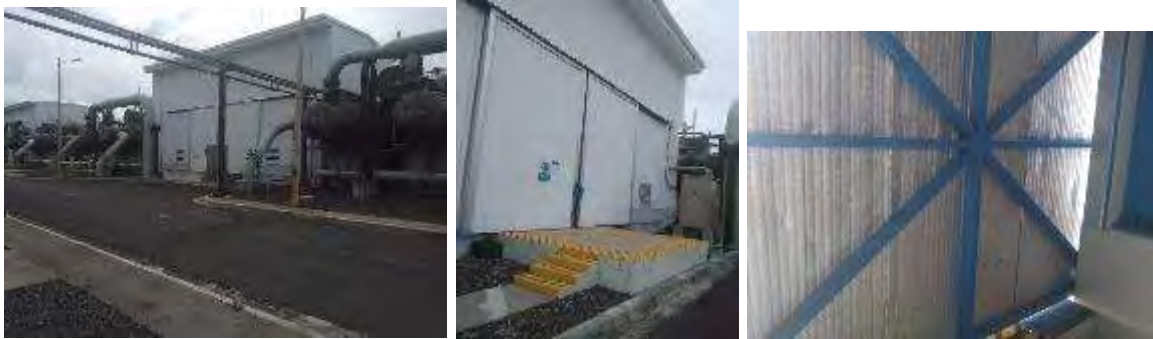
Figura 11. Casa de máquinas I y II con las puertas cerradas. Agosto, 2018.
