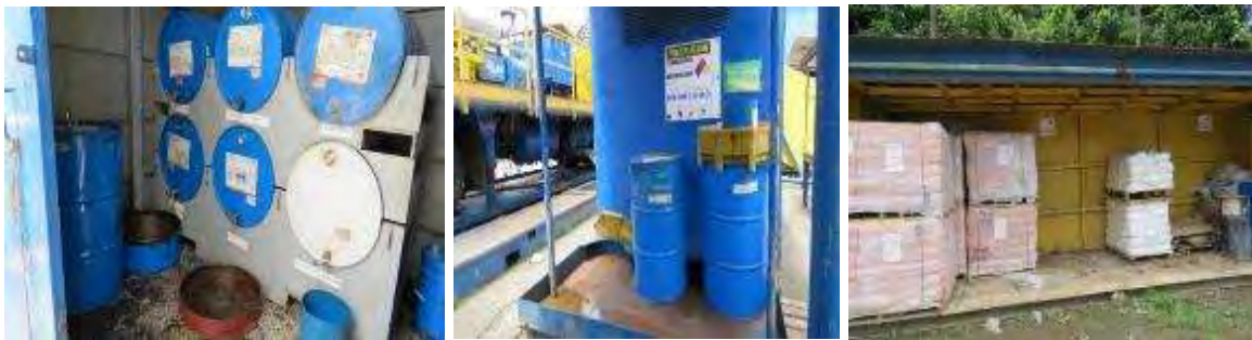
Figura 55. Áreas para almacenamiento de sustancias peligrosas en perforadoras.
