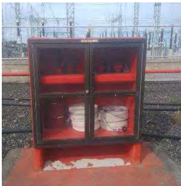
Figura 15. Gabinete con equipo contra incendios en buen estado, con mangueras, pitones y herramientas. 24 de agosto, 2018.
