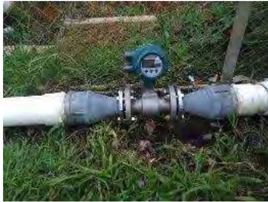
Figura 31. Salida del agua del sedimentador del agua tratada con medidor de flujo magnético. Se mantiene igual. Agosto 2018
