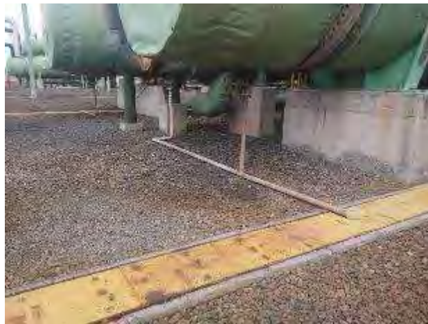
Figura 52 Vista del sistema de drenajes de condensados, setiembre 2018.
