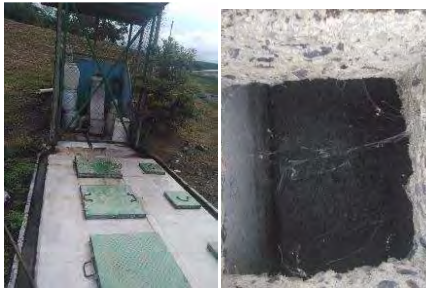
Figura 41. Tanque desengrasador. La grasa flotante se limpia tres veces por día (Proyectos). Agosto 2018
